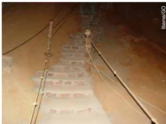
Escada de alvenaria construída sem autorização
